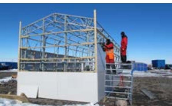
Vanhan helikopterihallin päällystystöitä. Installation of a new cover for a helicopter shelter. Kuva: FINNARP
